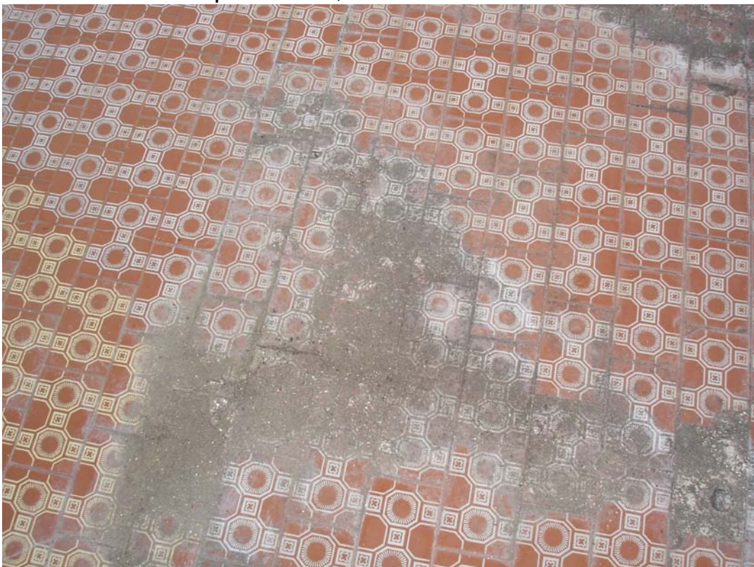
foto 14 zone del pavimento, con avvallamenti
